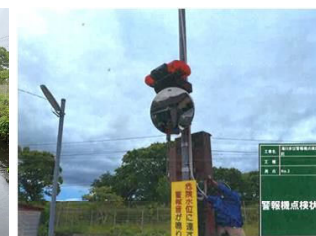
竜川水位警報機点検
