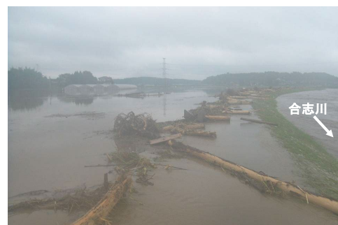
堤防上に残る流木 (山城堰上流右岸) H24.7.12
