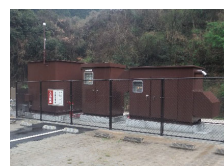
道の駅鹿北(熊本県)の非常用電源
