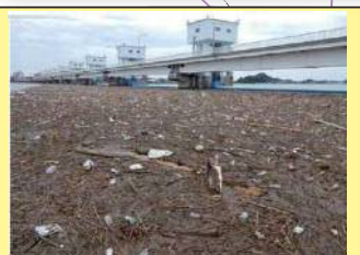
遠賀川 右岸2K000 河口堰 たくさんのごみが流れてきている。
